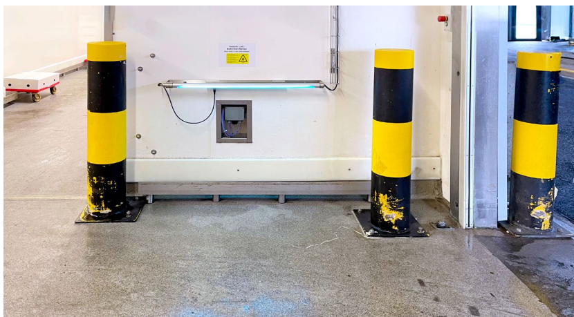
Ein einzelnes sterilAir-Modul sorgt für geringere Keimbelastung im Übergangsbereich
