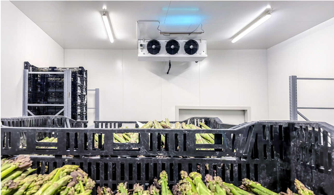
Depuis l'installation des EXB dans la chambre froide, les moisissures au plafond ont nettement diminué.
