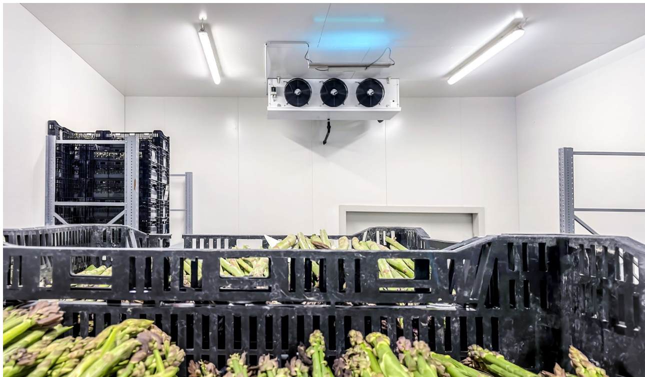
Seit Installation der EXB-Pendelleuchten im Kühlraum ist die Schimmelbildung an der Decke erkennbar zurückgegangen.
